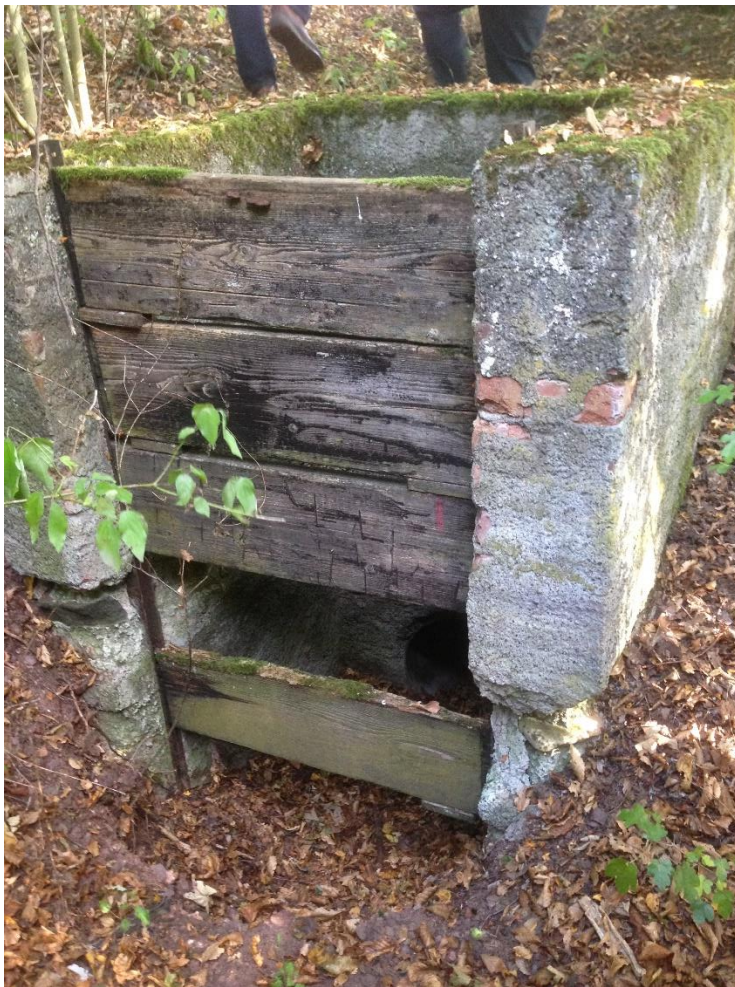
Abbildung 8 Sanierungsbedürftiges Mönchsbauwerk (GF 04)
